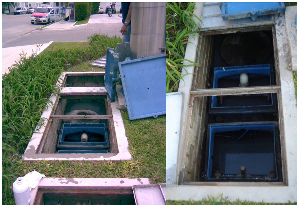
Figura 8: Sistema separador de água e óleo de caixa pré-fabricada
