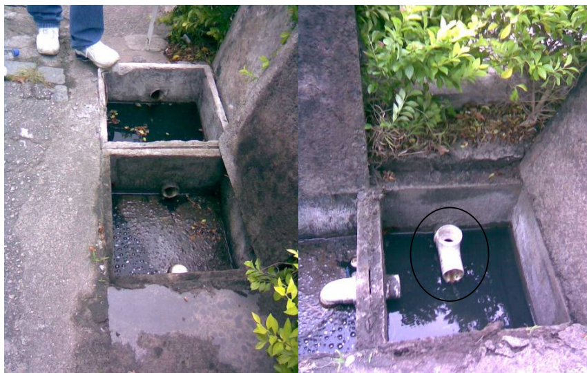
Figura 13: Sistema separador de água e óleo convencional do Posto Avenida
