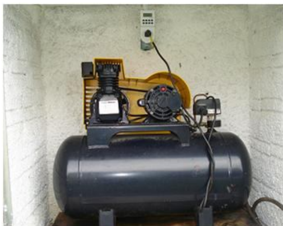
Figura 5. Compressor de ar
