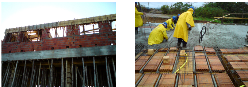
Figura 83 – a) Escoras em eucalipto, vigas e fechamento . b) Lajes com vigotas de concreto e tabelas de cerâmica.
