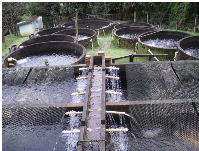
Figura 10. Calha de abastecimento dos quatro primeiros tanques
