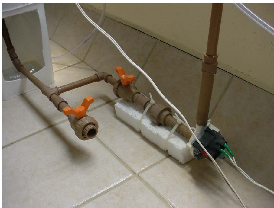
Figura 14: Bomba montada junto a registros para circulação de água fria.
