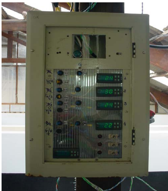
Figura 16: Quadro automatizado para controle da temperatura
