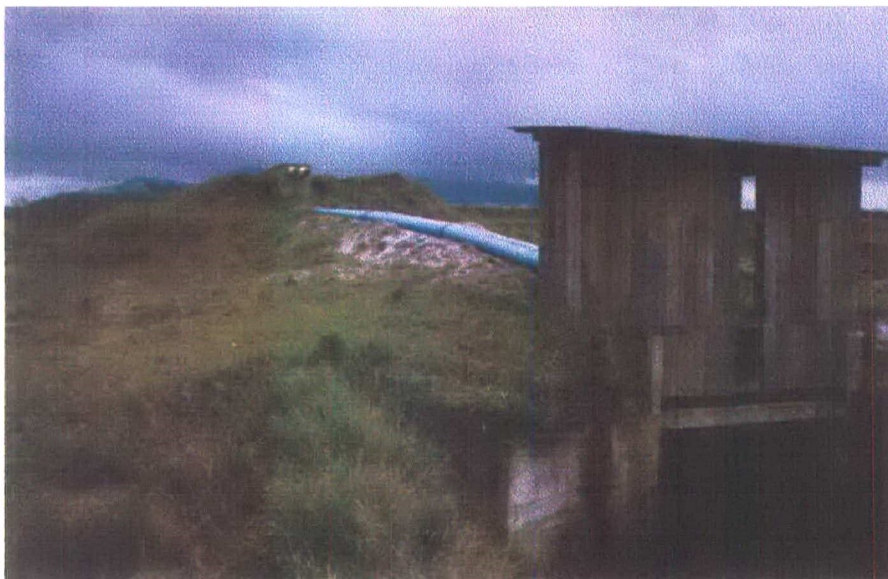
Figura 3. Estação de Bombeamento Secundária
