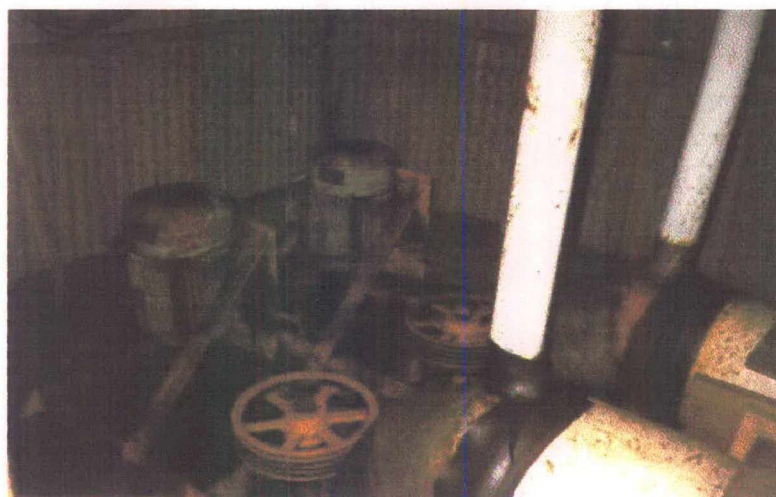
Figura 2. Bombas da estação de bombeamento principal
