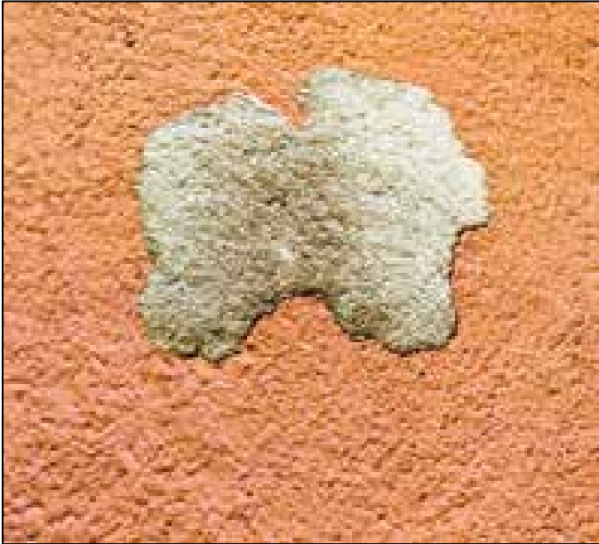
Figura 15 - Aspecto da desagregação
