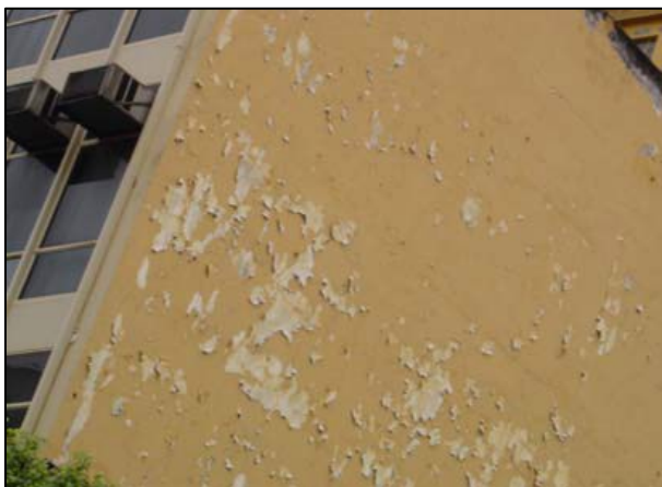
Descascamento da pintura.
