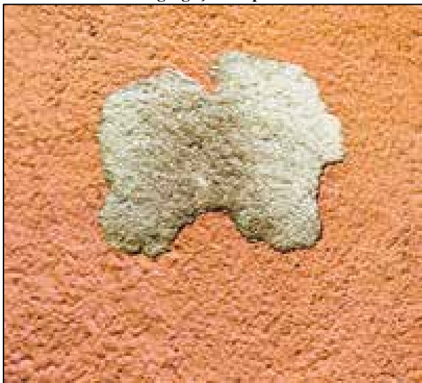
Esfarelamento da pintura.
