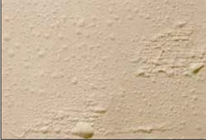
Figura 19 - Aspecto de bolhas na pintura
