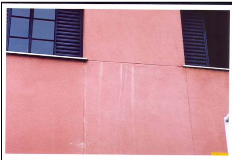
Figura 17 - Aspecto de eflorescência
