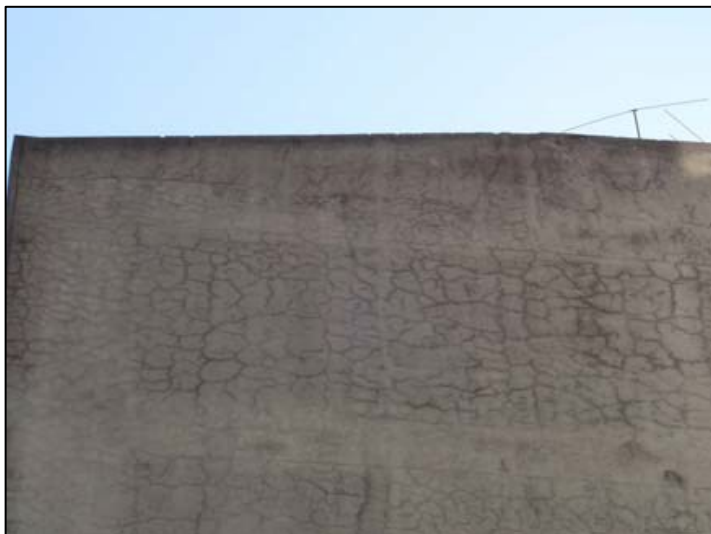
Figura 18 - Aspecto de fissuras mapeadas
