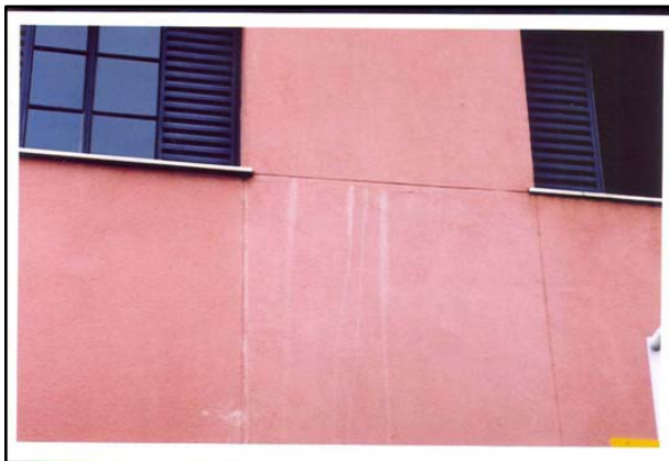
Manchas brancas na pintura.
