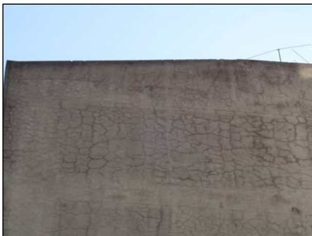
Pequenas fissuras em várias direções.
