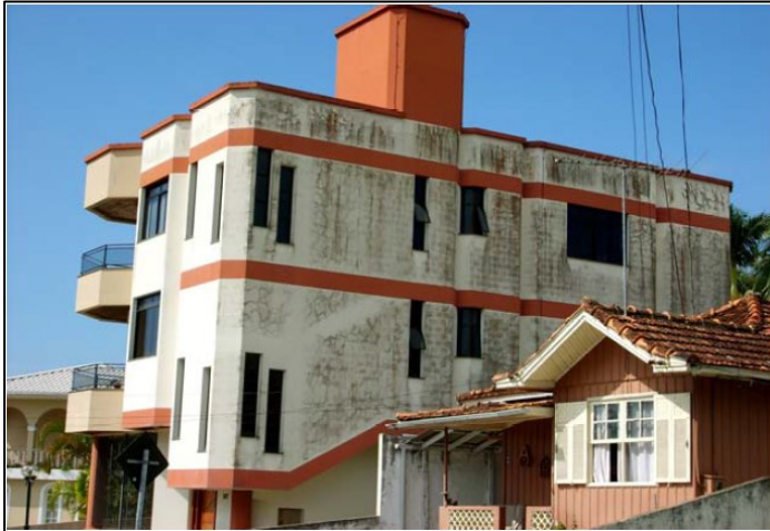
Figura 13 - Aspecto da biodeterioração
