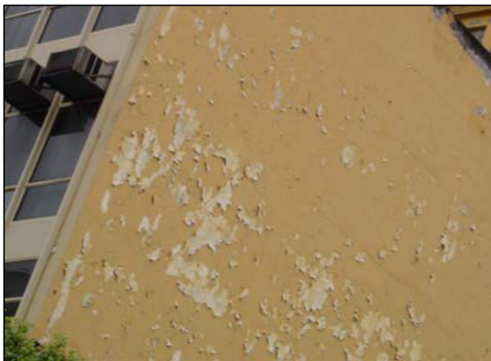
Figura 16 - Aspecto de descascamento
