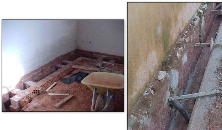
Figura 17 - Valas de aeração interna e externa, respectivamente
