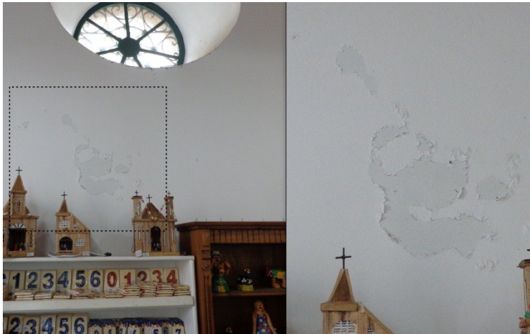
Figura 27 - Descascamento da pintura - Superfície interna, ala oeste
