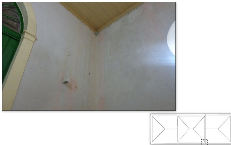
Figura 34 - Infiltração da água de precipitação - Pavimento térreo
