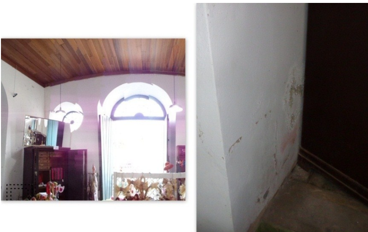
Figura 24 - Pulverulência da argamassa - Parede interna, ala oeste
