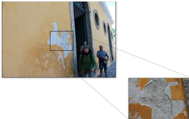
Figura 21 - Desprendimento pontual da argamassa
