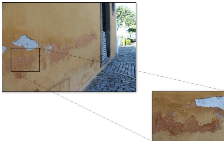
Figura 28 - Desprendimento da pintura a cal
