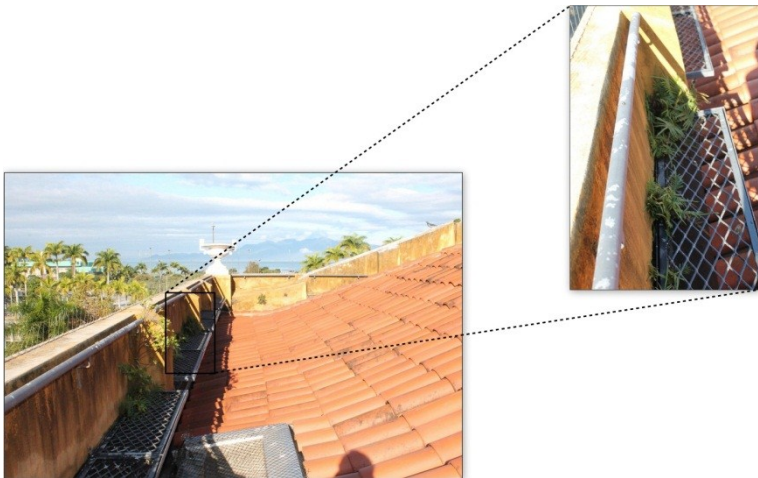
Figura 38 - Vegetação na cobertura
