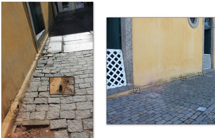
Figura 42 - Respiros das valas de aeração
