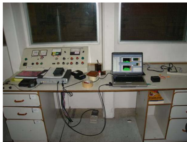
Figura 22 – Painel de controle elétrico, analisador e computador utilizados para aquisição dos sinais.
