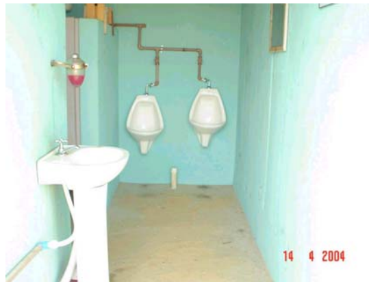
Figura 40: Mictórios posicionados em frente ao acesso.
