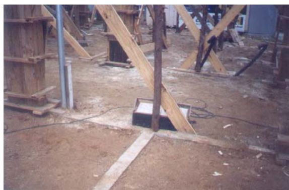
Figura 45: Conductor elétrico obstruindo a circulação.
