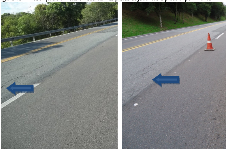
Figura 73– Presença de trincas e fissuras nas pistas adjacentes a pista experimental
