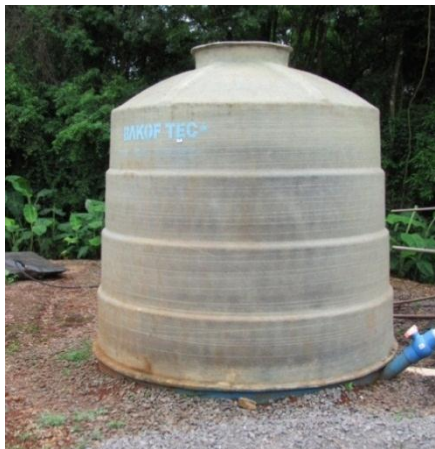
Figura14- Biodigestor da estação de tratamento de dejetos de suínos da Embrapa Suínos e Aves.
