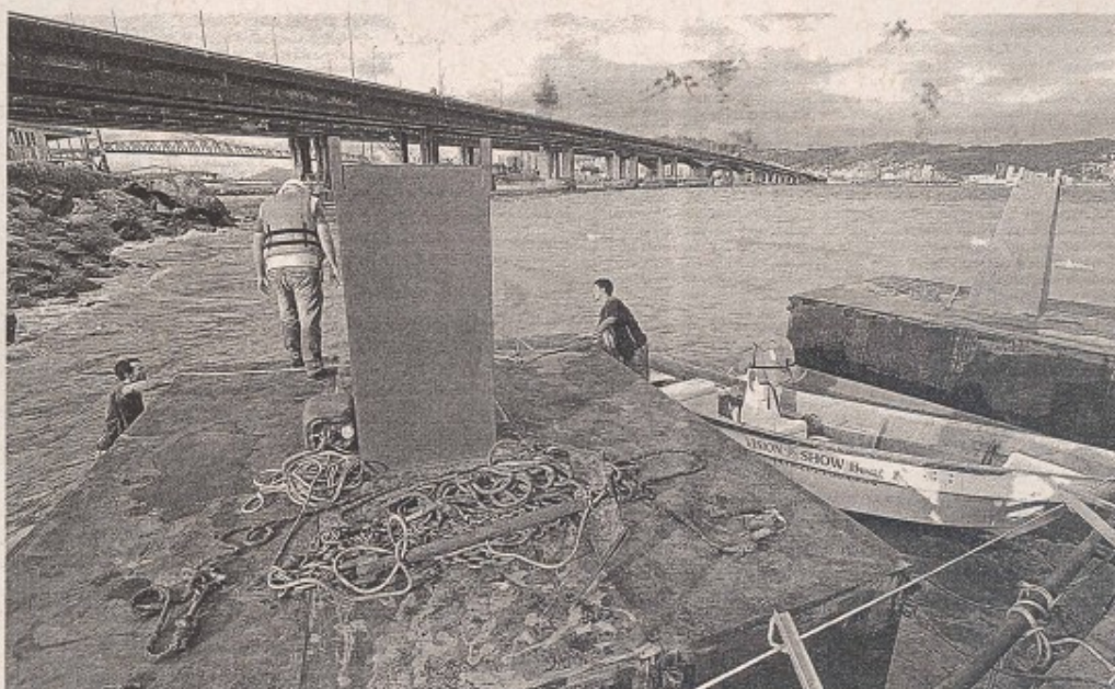
Balsas de sinalização começaram a ser preparadas ontem à tarde para isolar a área de onde serão retirados parapetos e 450 quilos de concreto
