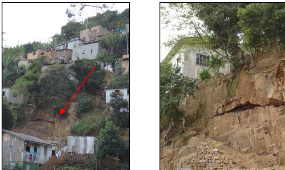
Figura 23: maciço rochoso fraturado representa perigo à população; à direita, detalhe do granito fraturado. Fonte: Arquivo CEPED (2006)
