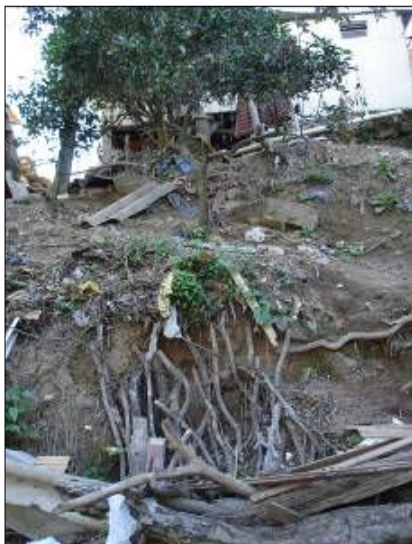
Figura 30: talude de aterro elaborado com restos de lixo. Fonte: Arquivo CEPED (2006)
