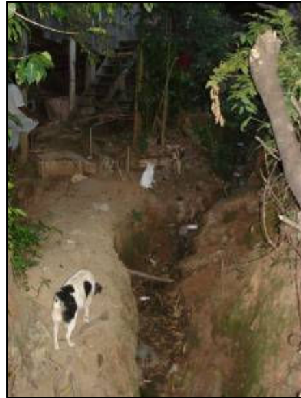
Figura 37: sem sistema de drenagem, as águas superficiais (se) concentram pelas vias de acesso dos moradores.
