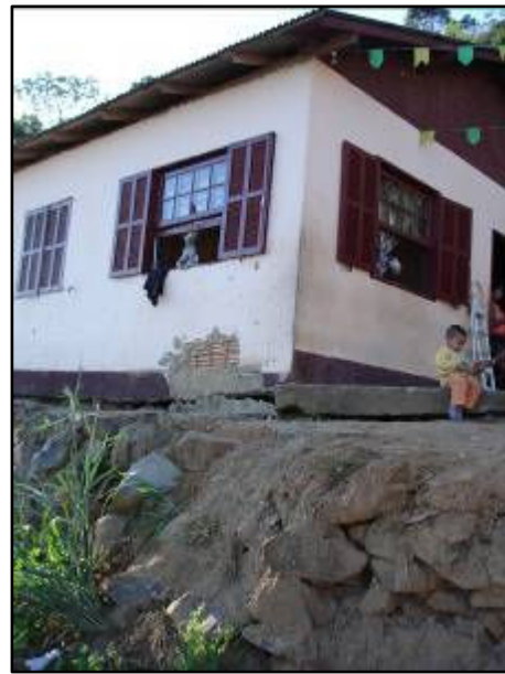
Figura 45: material de escorregamento pretérito utilizado como aterro. A casa já foi atingida por escorregamento, na parte dos fundos. Fonte: Arquivo CEPED (2006)
