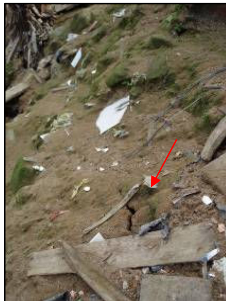
Figura 27: trinca no terreno em meio aos escombros de uma casa que já desabou. Fonte: Arquivo CEPED (2006)
