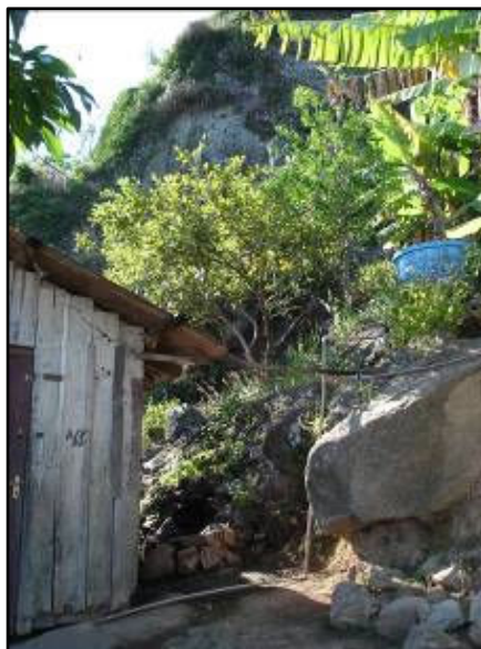
Figura 43: blocos perdendo a sua sustentação devido aos cortes feitos para a construção das casas. Fonte: Arquivo CEPED (2006)
