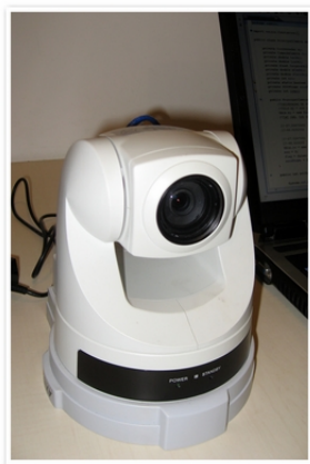
Figura 26: Câmera PTZ que equipa um ponto infraestruturado às margens da rodovia.
