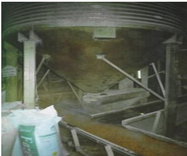
Figura 17: Tanque de Metal- Coopersulca (Turvo).
