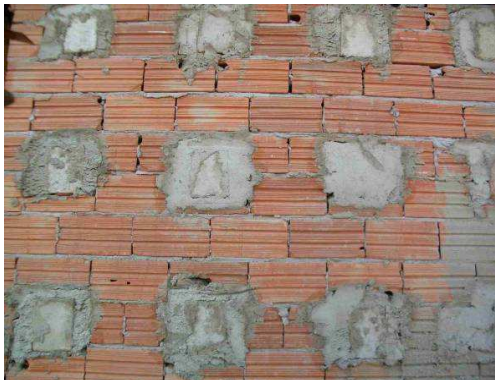
Figura 5 – Elementos de concreto inseridos na alvenaria. Fonte: Do autor.
