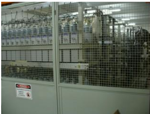
Figura 40 – Banco de capacitores usado nos ensaios.
