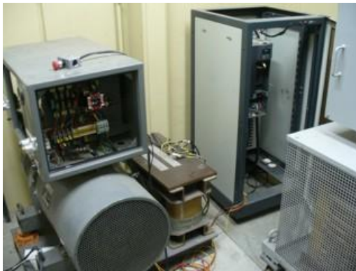
Figura 39 – Gerador usado nos ensaios.
