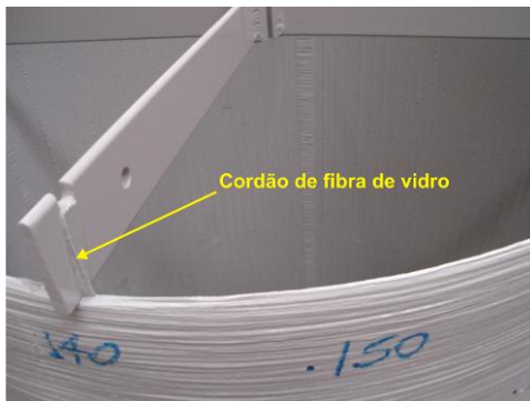
Figura 31 – Detalhe da fixação das cruzetas no reator.
