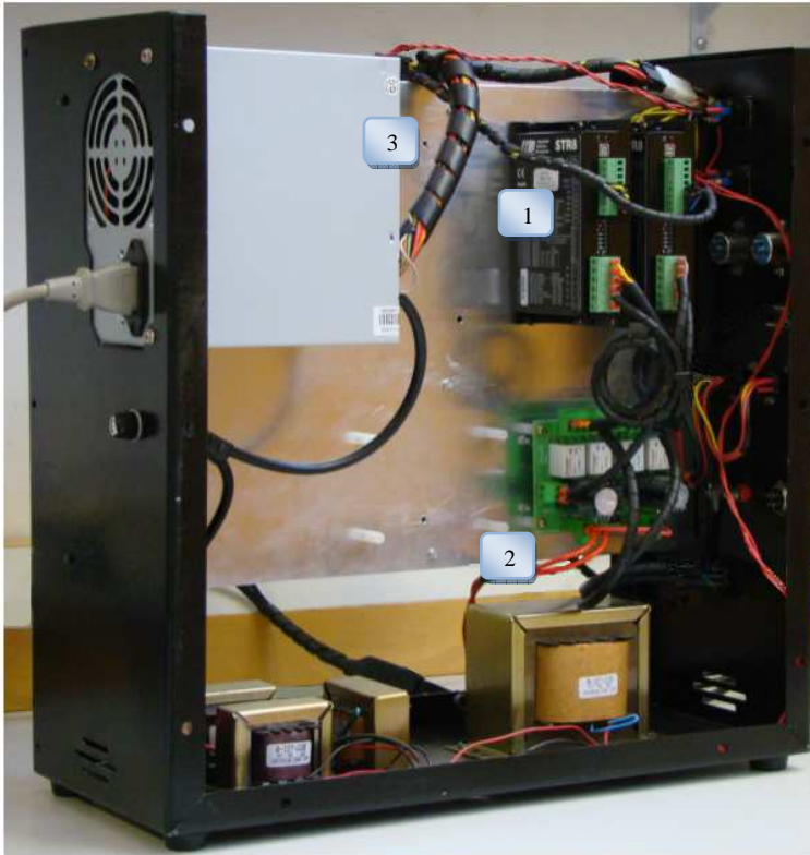
Figura 51 – Lado esquerdo do painel eletroeletrônico de controle e acionamento do Tartilope V2F
