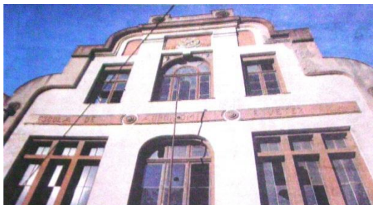
Figura 72 - Vidraças quebradas e sujeidade na fachada frontal, outubro de 2006- Fonte: Jornal da Universidade p.2.
