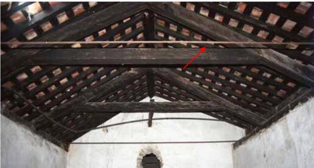
Fig. 17. Vista do desvão da Igreja de Rosário dos Pretos, Recife. Barras de ferro atirantadas para solucionar empuxo lateral nas paredes. Fonte: Renata Lopes, outubro de 2002,
