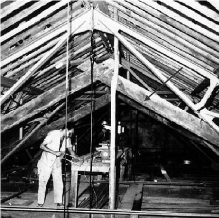
Figura 41 – Igreja N. Senhora do Carmo, Olinda, e a preservação de algumas tesouras originais sem função estrutural. Fonte: Pereira (2003)
