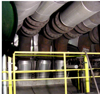
(b) Dutos de entrada de carvão na parte externa da fornalha.
