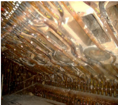
(a) Vista interna dos queimadores na fornalha.
