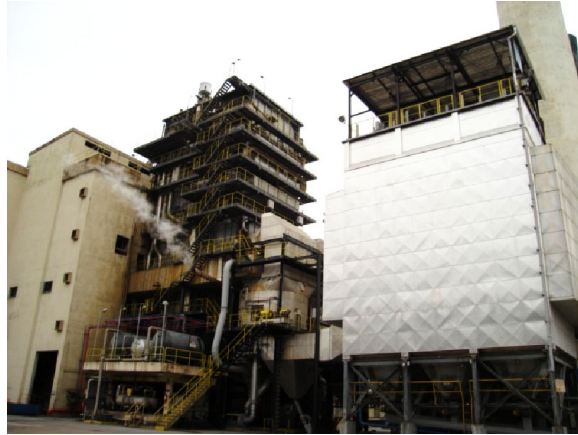
(a) Foto externa do gerador de vapor.
