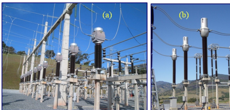
Figura 2.6 - TC na subestação fabricante AREVA, (a) TC 69 kV – modelo QDR – cabeça encapsulada em resina; (b) TC 750 kV – modelo CTH – cabeça encapsulada em alumínio [1].
