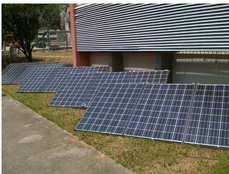
Arranjo Fotovoltaico Implementado – Foto 1
