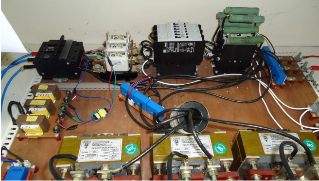
Entrada Rede, Dispositivos de Proteção, Indutores e Sensores.
