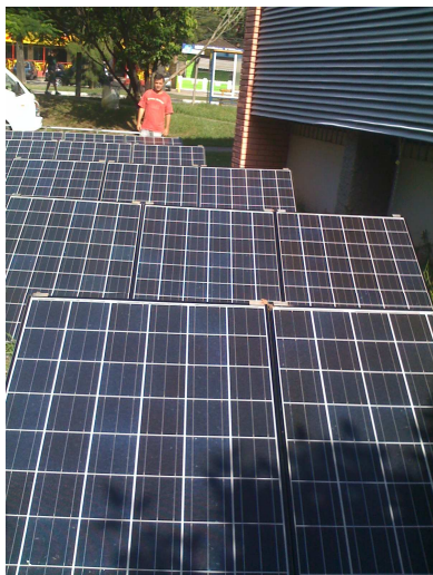
Arranjo Fotovoltaico Implementado – Foto 2
