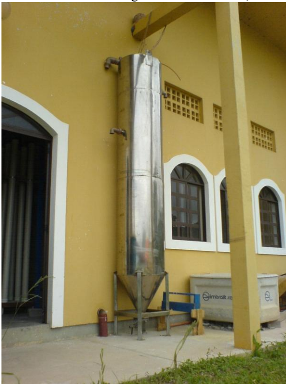
Figura 4.1 – Foto do filtro de lavagem contínua de \Phi 0,60 m.
