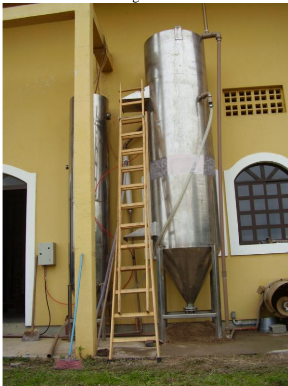
Figura 3.8 – Foto do filtro de lavagem contínua.
