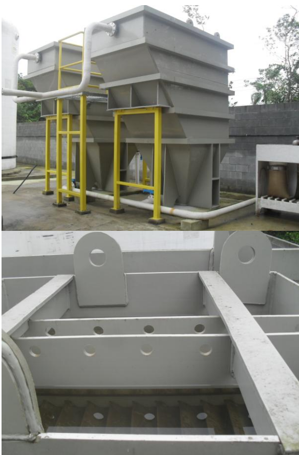
Figura 4.45 – Fotos do decantador lamelar, do sistema de secagem de lodo e do reservatório de água de lavagem.
