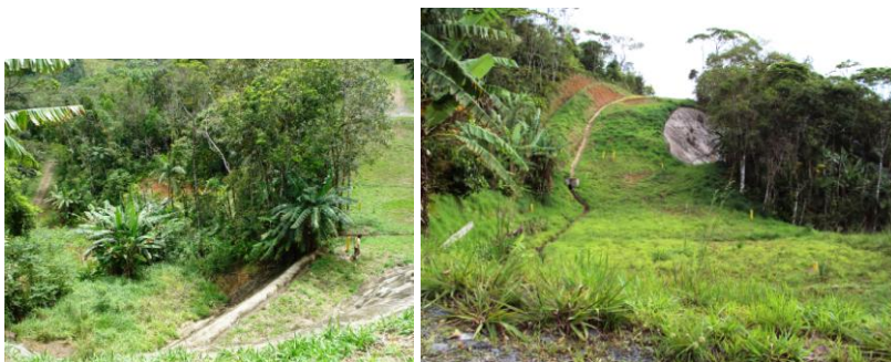
Figura 113- Escorregamento P. Foto: Fernanda Bauzys (2010).
