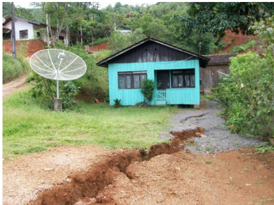
Figura 15 -Fendas no solo. Alto do Baú, em Ilhota, SC. Foto: Fernanda Bauzys (2009).
