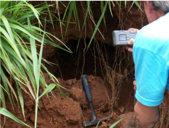
Figura 7-Piping no Alto do Baú. Foto: Fernanda Bauzys (2009).
