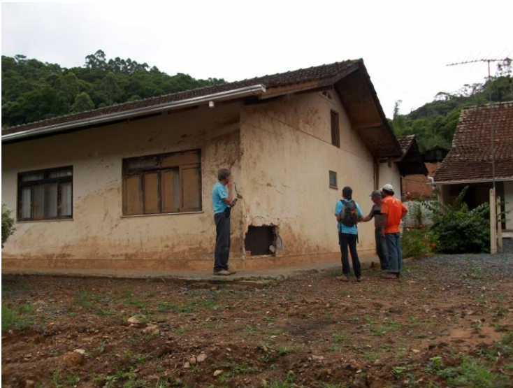
Figura 49- Esta residência foi atingida pelo escorregamento 3, que trouxe muito lodo e um tronco de árvore entrou pela parede da casa. Foto: Fernanda Bauzys (2009).
