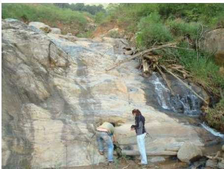
Fe12g: Fraturas abertas com direção N80E;80°N, acompanhando a direção do córrego e do deslizamento.
