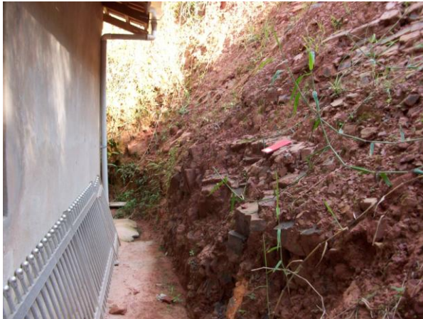
Figura 29 -Exemplo de casa em situação de risco em Blumenau-SC. A rocha do talude um metapelito do grupo Itajaí, alterado e fraturado, apresenta um mergulho favorável a um deslizamento. Foto: Fernanda Bauzys (2009).
