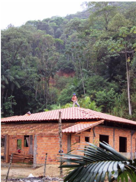
Figura 90- Escorregamento 31. Foto: Fernanda Bauzys (2010).
