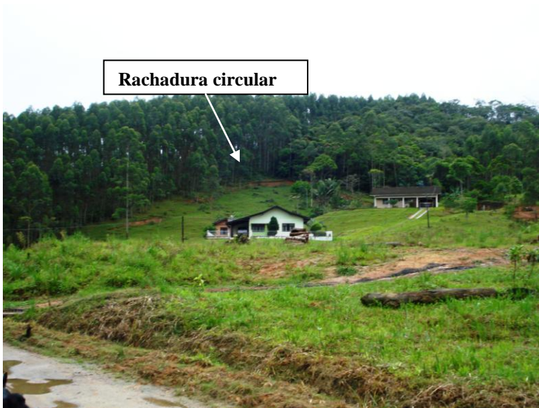
Figura 77 -Ruptura circular atrás de residência. Foto: Fernanda Bauzys (2010).
