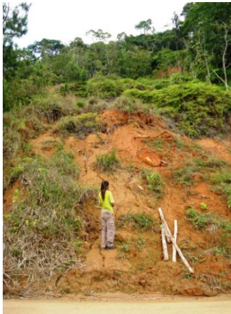
Figura 103- Escorregamento F. Foto: Fernanda Bauzys (2010).
