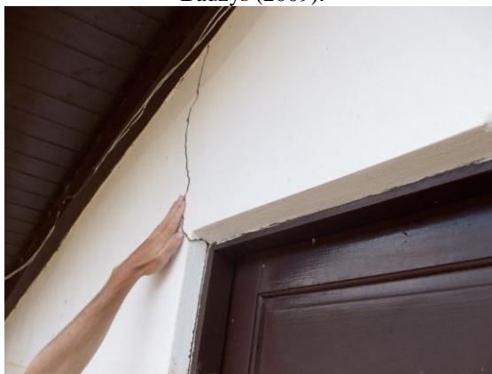
Figura 16 -Fissuras nas paredes. Braço do Baú, em Ilhota, SC. Foto: Fernanda Bauzys (2009).
