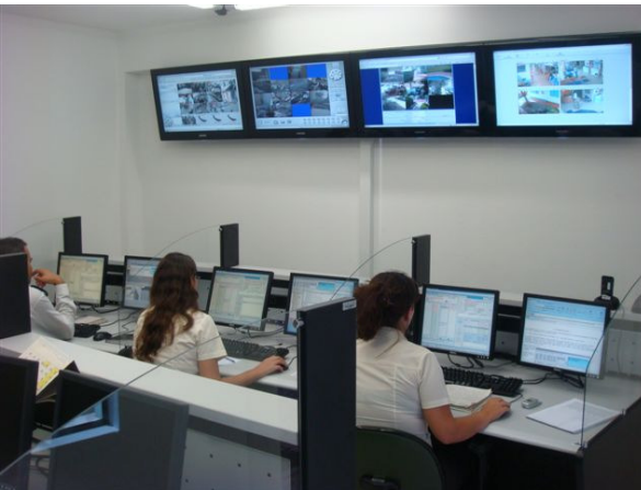
FOTO 2 - Sala de monitoramento – geral
