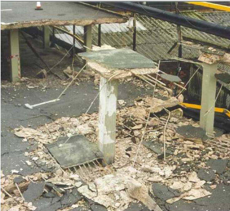
Figura 1.3 – Colapso de uma garagem
