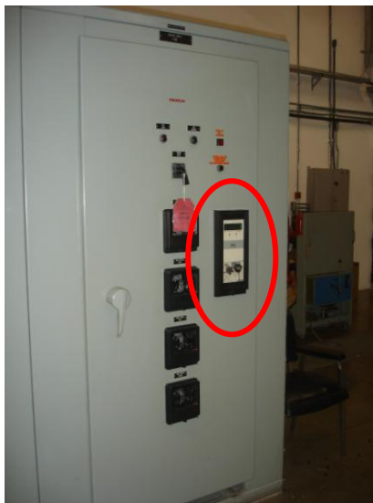
Figura 23 – Transformador 3 com o equipamento de medição instalado (demarcado em vermelho)
