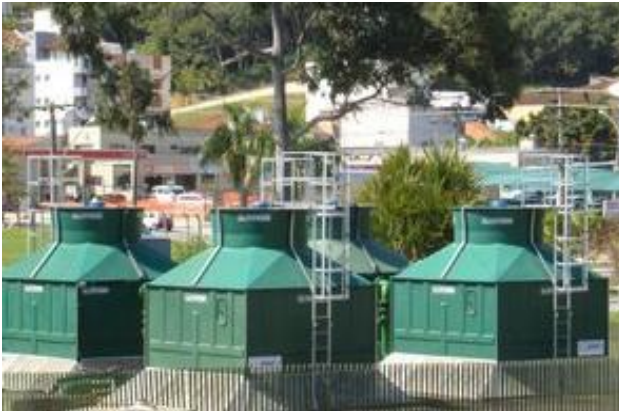
Figura 10 – Torres de arrefecimento, 2007
