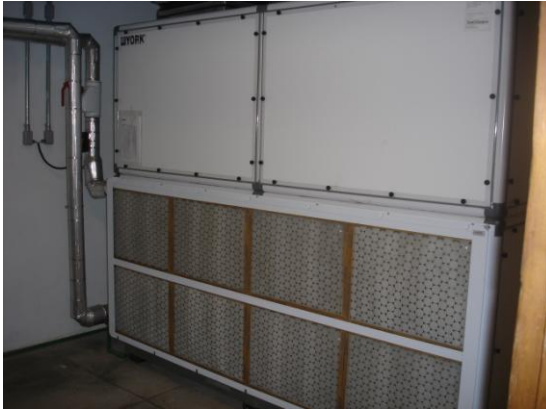
Figura 15 - Um dos climatizadores e ventiladores de ar do primeiro pavimento, 2009
