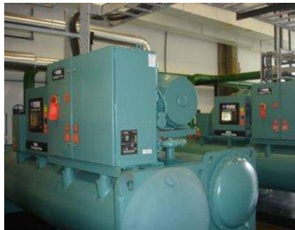
Figura 12 – Resfriadores de líquido, 2007
