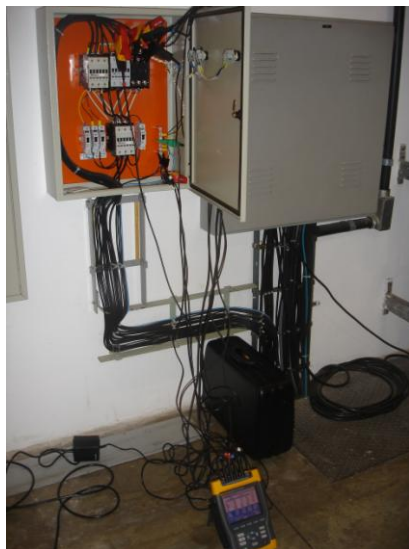
Figura 26 – Instalação do analisador de energia no quadro elétrico dos três elevadores
