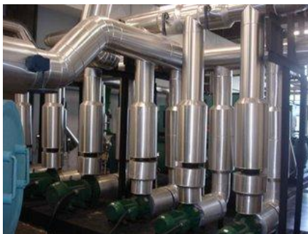
Figura 13 – Tubulação de água gelada, 2007
