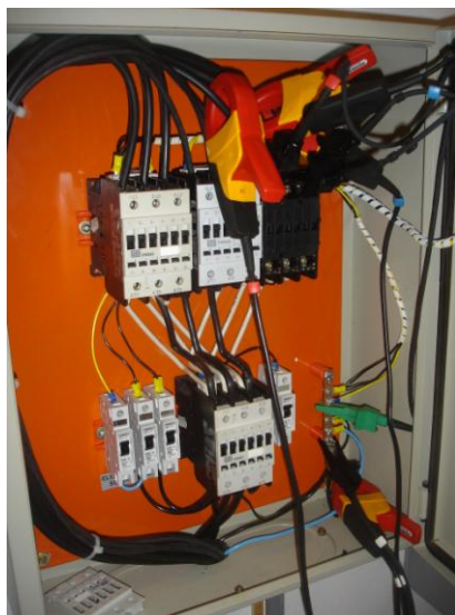
Figura 27 - Conexão dos cabos do analisador de energia com os fios de fase, terra e neutro do quadro elétrico dos três elevadores
