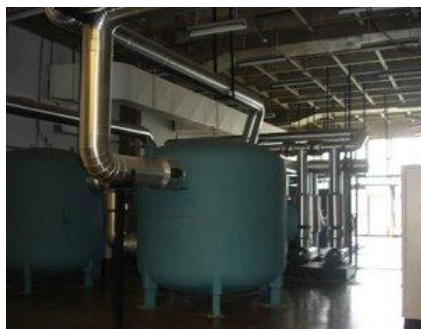
Figura 14 – Tanques de equalização de vazões e temperaturas, 2007
