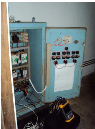
Figura 28 – Conexão do analisador de energia ao quadro elétrico das bombas de recalque
