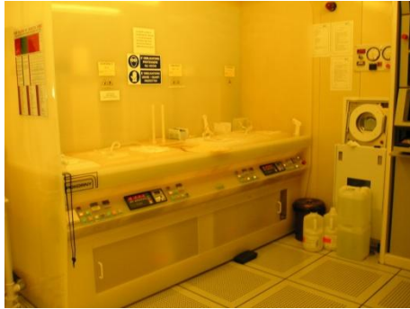
FIGURA 8.11 - Capela química de limpeza e centrífuga de secagem
