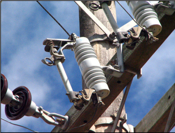
Figura 4.17 – Instalação de Chave Fusível
