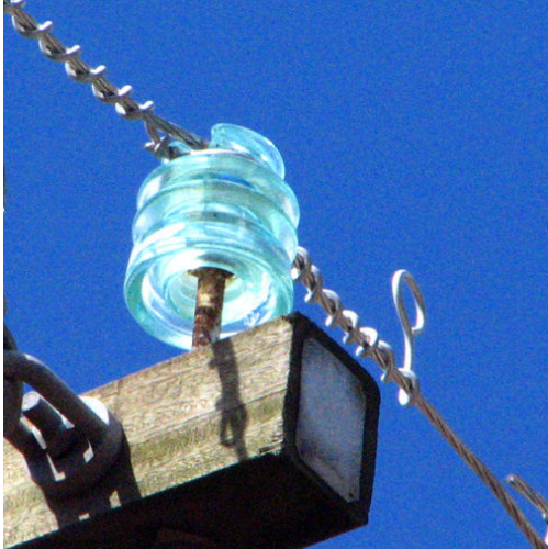
Figura 4.12– Isoladores do Tipo Hi-top Vidro
