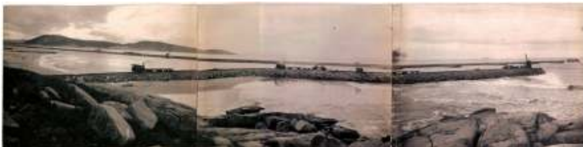
Fig. 25: Construção dos molhes para melhorar o acesso ao porto, 1900. Fonte: Acervo ETEC Laguna – IPHAN/SC, 2010.
