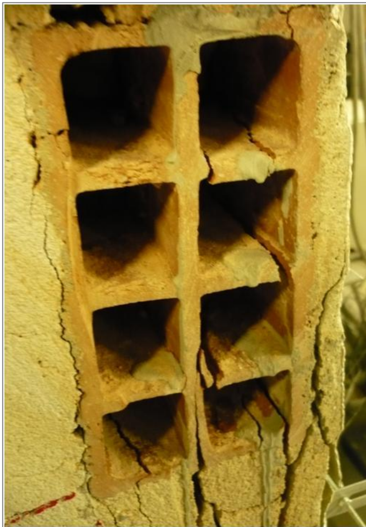
Figura 125 – Fissuração nos blocos e descolamento dos revestimentos
