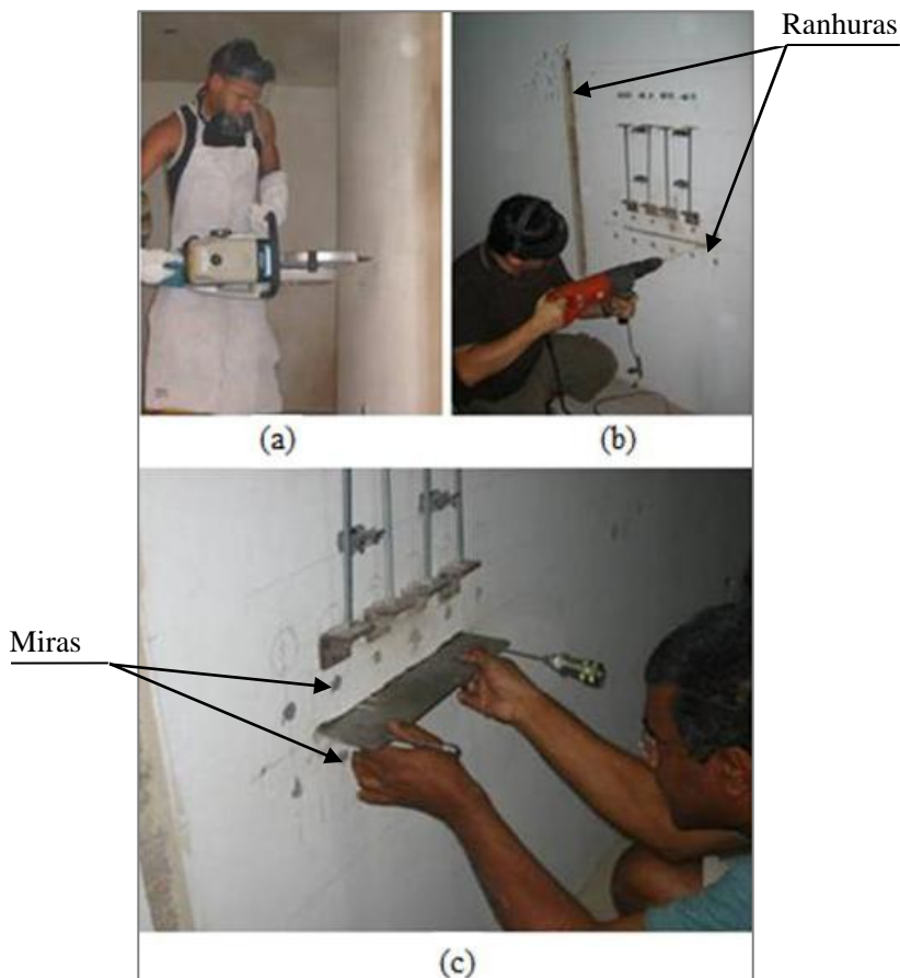
Figura 56– Execução da ranhura para os ensaios: (a) abertura inicial com a cortadora a disco; (b) aperfeiçoamento da ranhura com uma furadeira eléctrica; e (c) introdução do macaco plano
