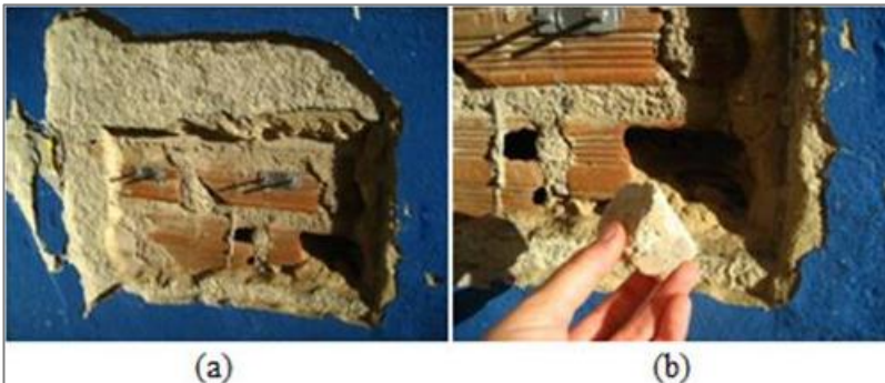
Figura 78 – Ensaio de dano acumulado através de EA: (a) localização dos pontos de leitura para os ensaios de dano acumulado; e (b) má qualidade dos tijolos
