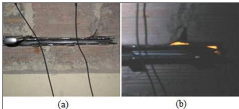
Figura 66 – Detalhe do mau contato entre as chapas de interposição e os blocos cerâmicos.
