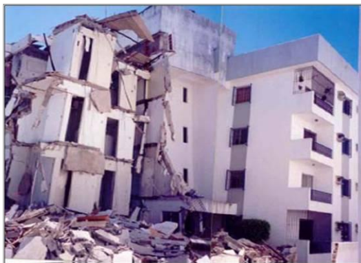
Figura 28 – Desmoronamento do Edifício Ijuí
