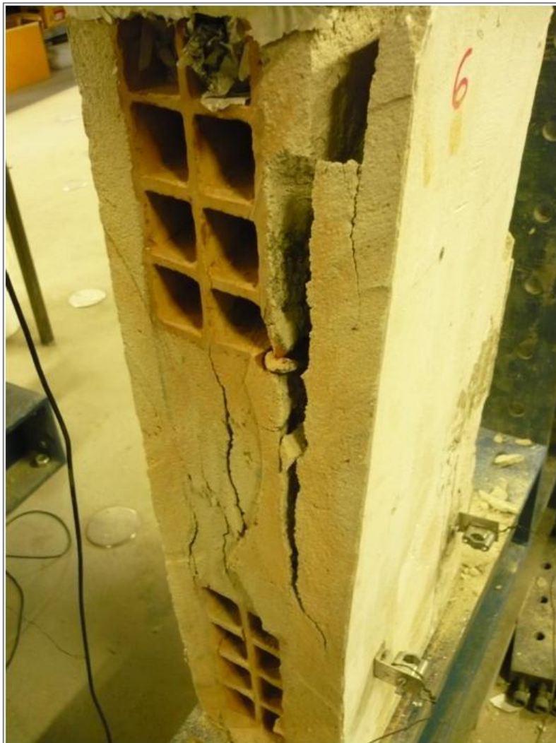
Figura 126 – Visualização do destacamento do revestimento no P6
