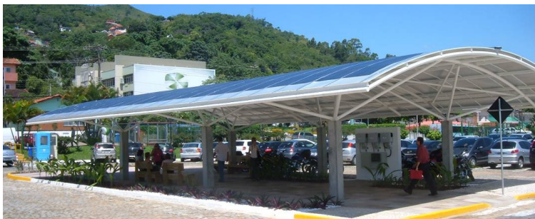
Figura 55. Protótipo de 12 kWp em operação na Eletrosul desde 2009.
