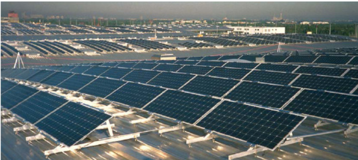
Figura 25. Munich Trade Fair Centre: instalação de 1 MW na cobertura (CUNOW e GIESLER;2001).
