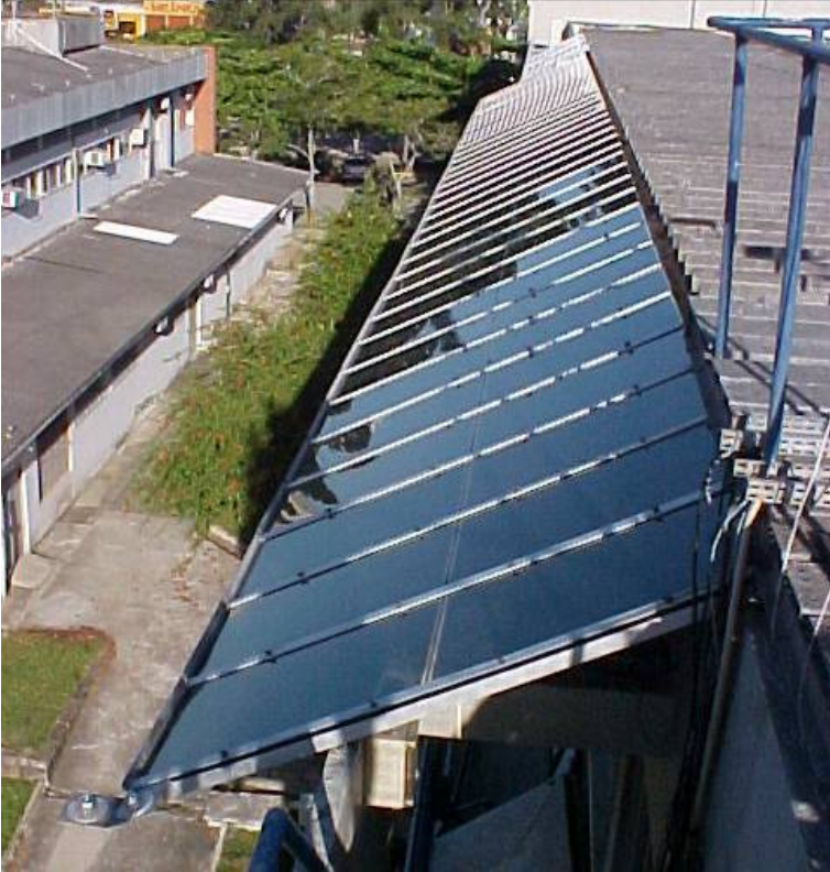
Figura 29. Primeiro sistema fotovoltaico conectado à rede e integrado a uma edificação no Brasil: Sistema de 2 kWp localizado em Florianópolis-SC, em operação desde 1997.
