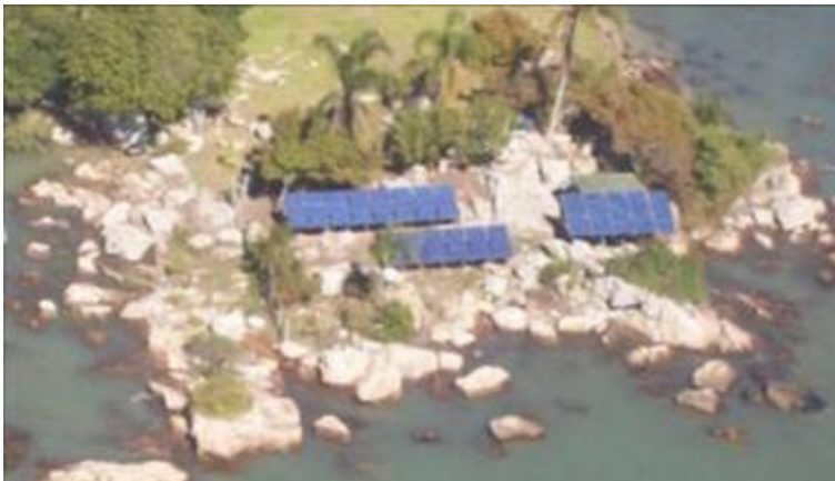
Figura 15. Sistema fotovoltaico isolado instalado na Ilha de Ratonés.
