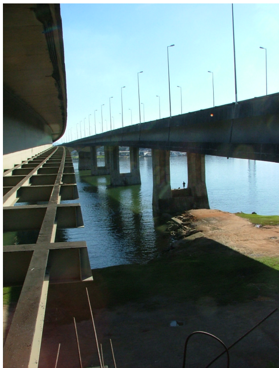
Figura 54 – Passarela inacabada do lado direito da Ponte Pedro Ivo. Fonte: da autora, 2004
