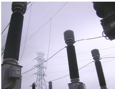
Figura 14: Transformador de corrente indutivo – TC.
