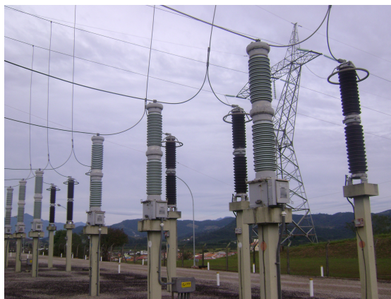
Figura 13: Transformador de potencial capacitivo – TPC.
