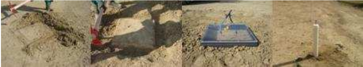
Figura 19. Seqüência para cravamento da placa de fluxo e o tubo de PVC.
