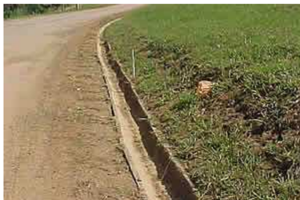
Figura 4. Drenagem de águas pluviais.
