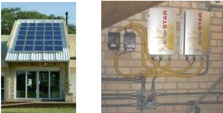
Figura 10 – Sistema FV p-Si instalado na Casa Eficiente da ELETROSUL e detalhe dos inversores utilizados
