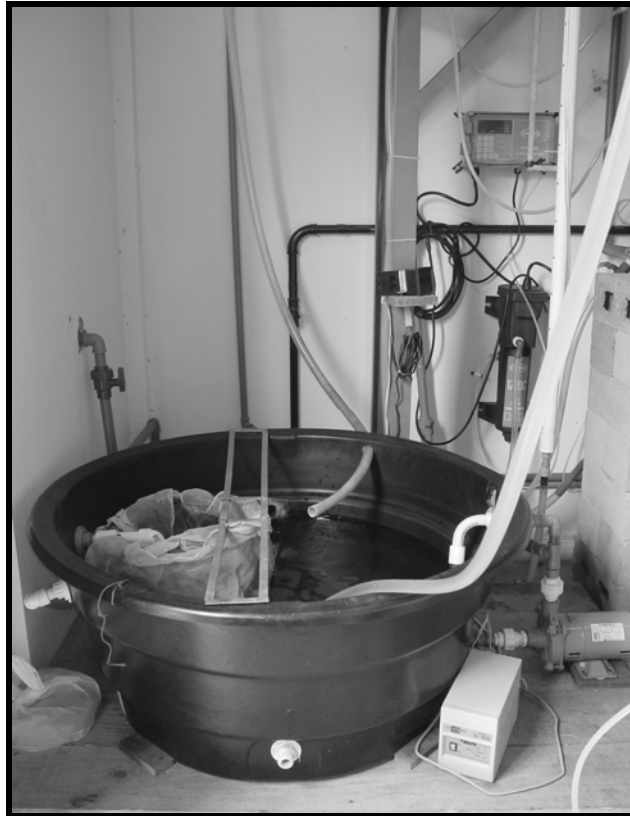
Figura 21: Foto da câmara de carga (reservatório 1) da Água tipo I e da Água tipo III
