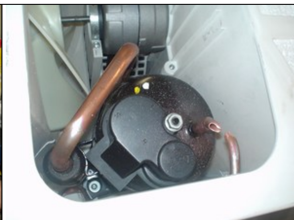
H - Rompimento do tubo em função de interferência com gabinete do CA.
