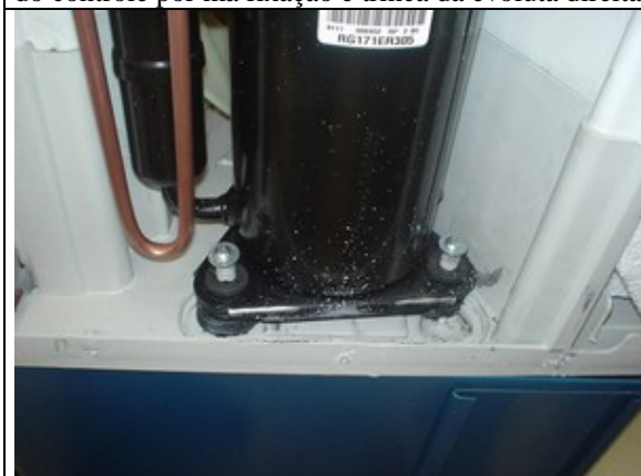
I - Quebra dos pinos de fixação do compressor.
