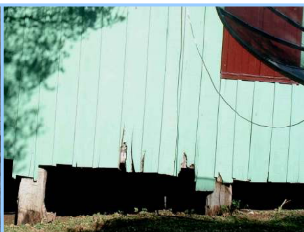
Figura 25 – Detalhe de tábuas da parte externa de casa de agricultor do município de Anchieta, que precisa ser reformada.
