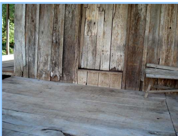
Figura 24 – Detalhe de parte externa de casa de agricultor do município de Anchieta/SC que necessita de reforma.
