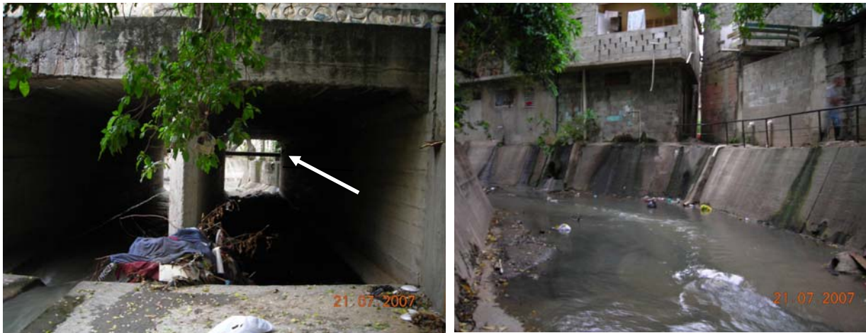
Figura 31 - Córrego na avenida Circunvalación para água pluvial, trecho L-22 no ponto C
