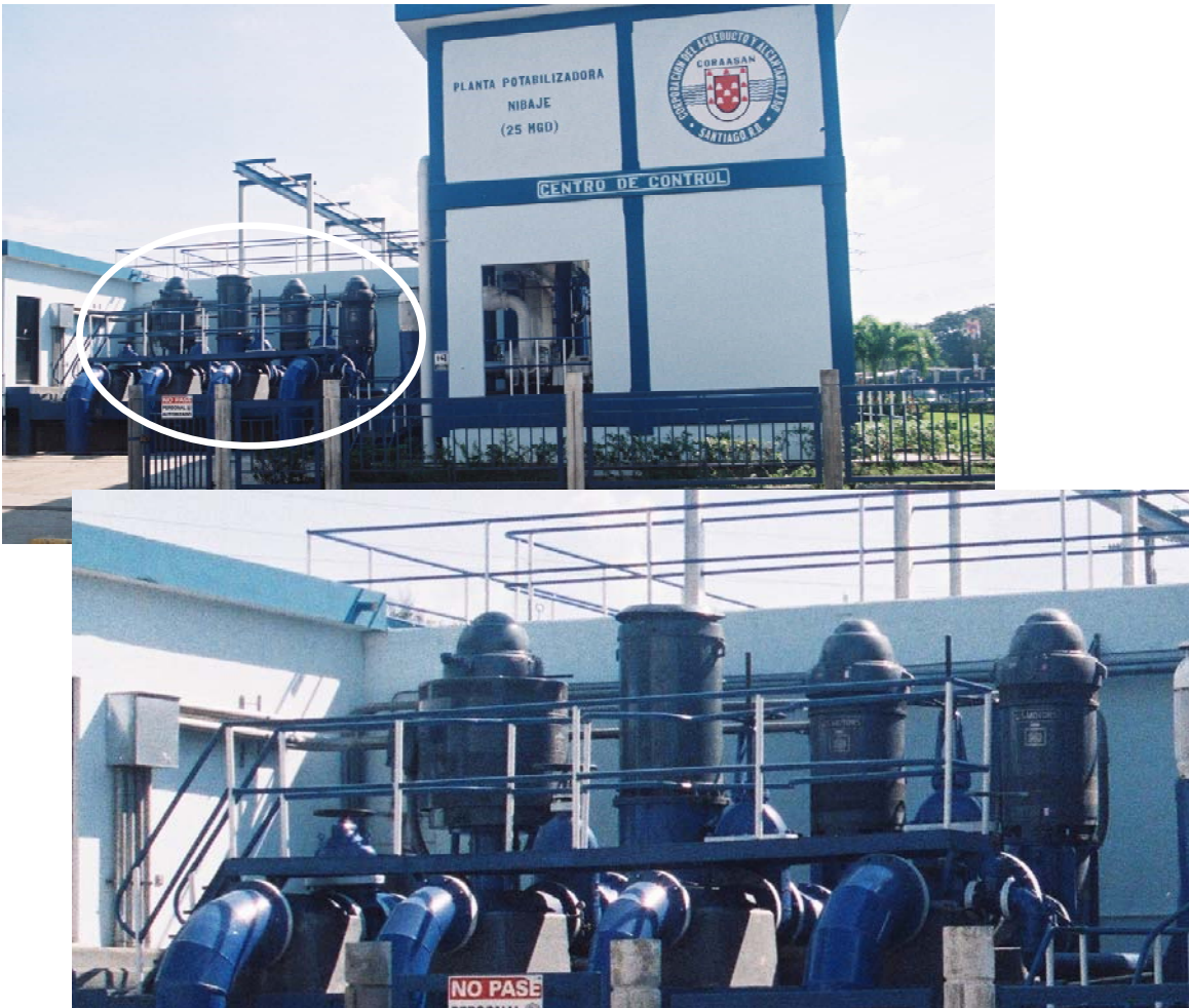
Figura 11 - Foto da estação de bombeamento da ETA Nibaje-25, Santiago de los Caballeros
