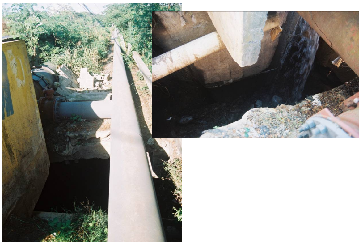
Figura 32 - Adutora de água tratada da ETA La Noriega sobre a ponte na rua E. Sadalhá (Córrego Nibaje), novembro de 2005
