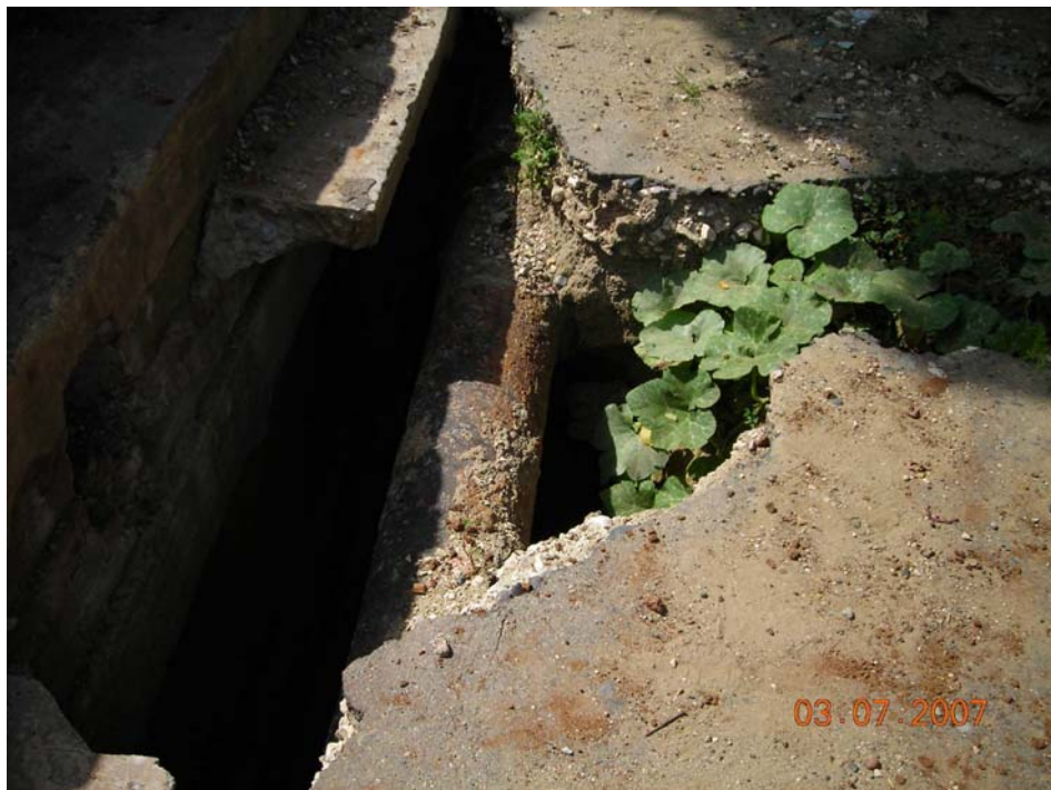
Figura 30 - Condição do trecho L-8 na ponte antiga sobre o córrego Nibaje
