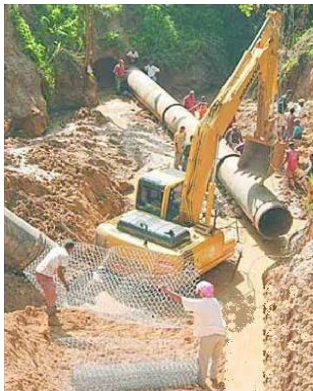
Figura 34 - Foto da destruição da adutora do sistema de água da cidade de Moca, República Dominicana
