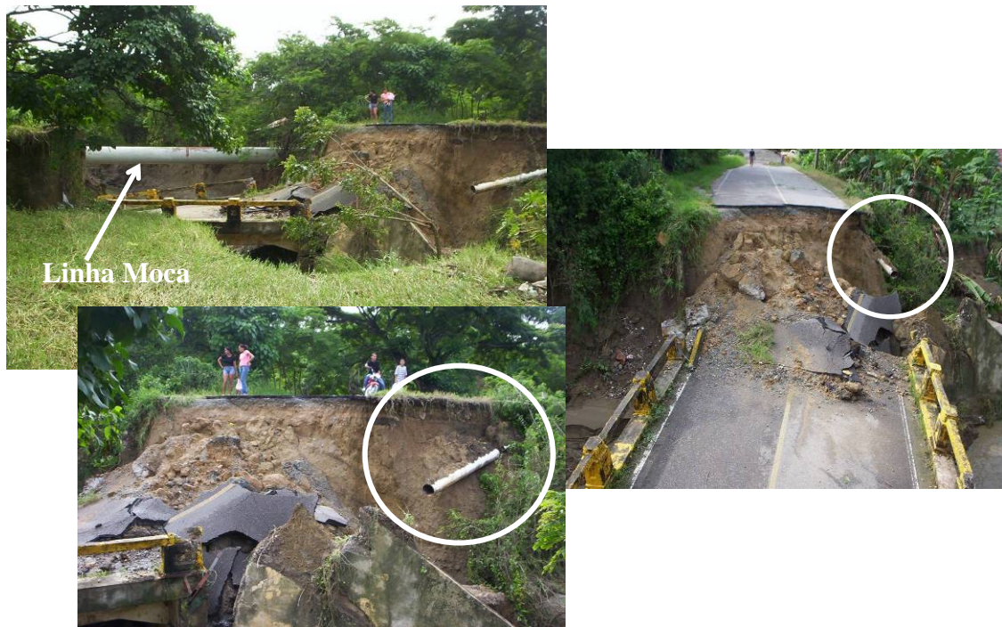
Figura 35 - Foto de avaria na linha principal da rede de distribuição de água da comunidade Puñal, República Dominicana, maio de 2007
