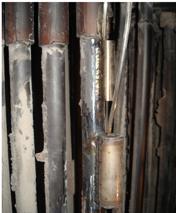
Figura 5.2 – Sensores instalados no superaquecedor final.
