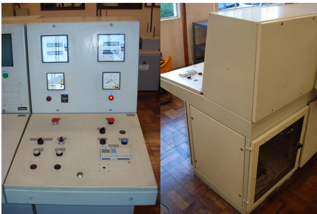
Figura 3.21 - Vista externa da bancada de ensaio de vida em capacitores.
