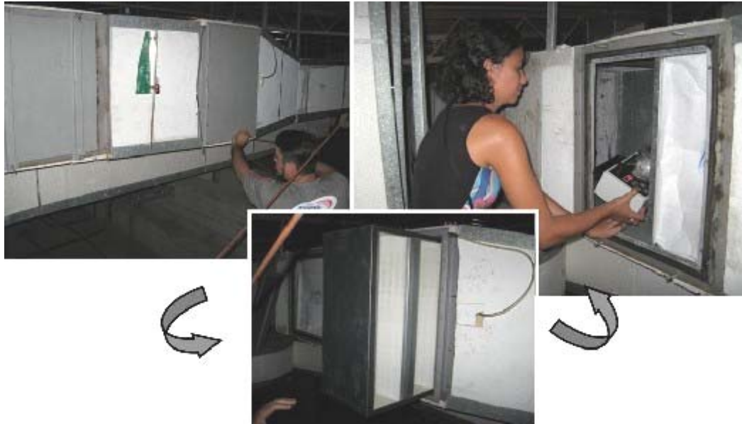
Figura 26: Amostragem no sistema de ar condicionado
