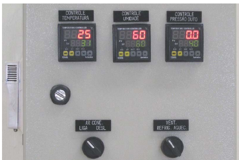
Figura 17: Painel de controle de temperatura e umidade da UTI
