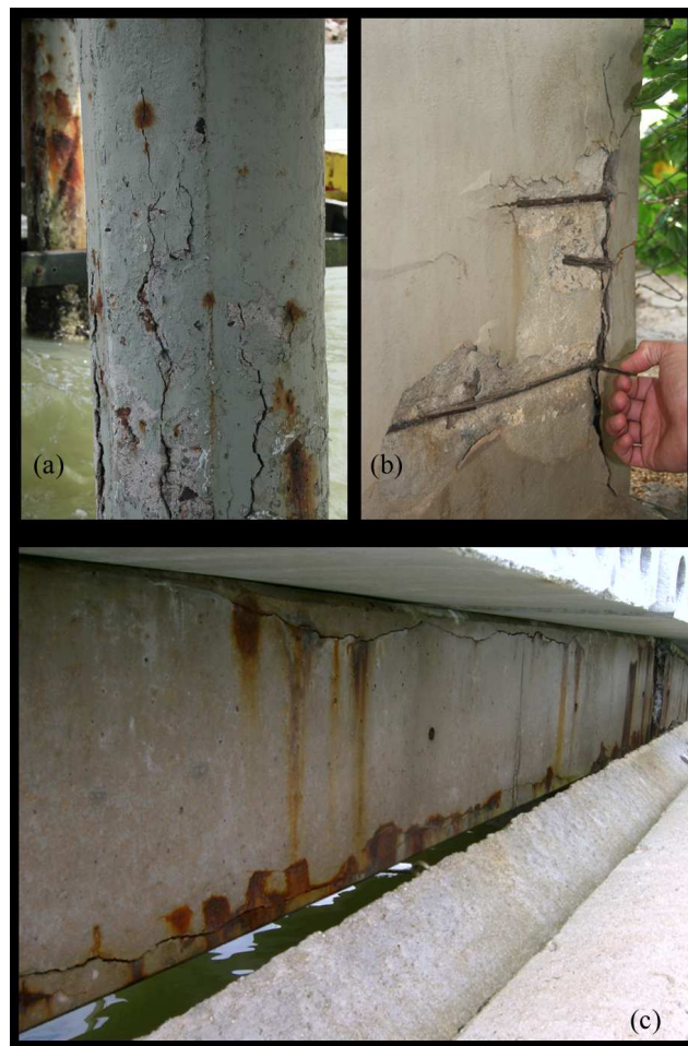
Figura 4.12 – Problemas de corrosão em Florianópolis: (a) Pilar do trapiche da Beira-mar Norte. Foto: Moacir Carqueja. (b) Pilar da cabeceira insular da Ponte Colombo Salles. Foto: Moacir Carqueja. (c) Viga principal do trapiche do Iate Clube de Santa Catarina – Veleiros da Ilha.
