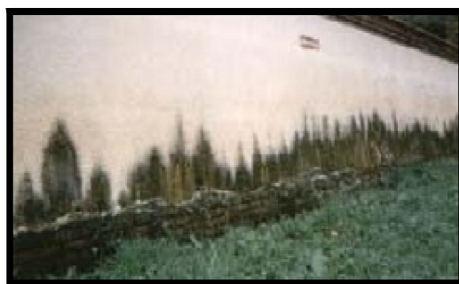
Ilustração 21. Umidade ascendente numa parede exterior
