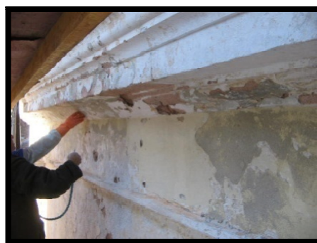
Ilustração 46. Desprendimento de tinta das cimalthas
