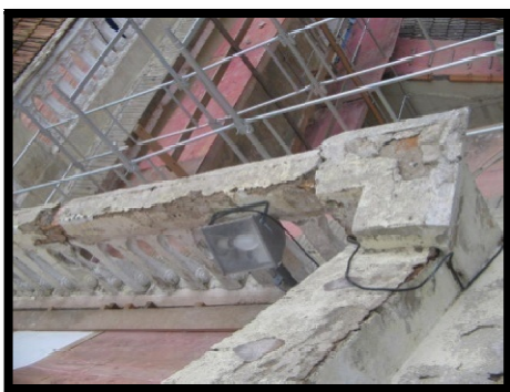
Ilustração 45. Balaústres superiores deteriorados
