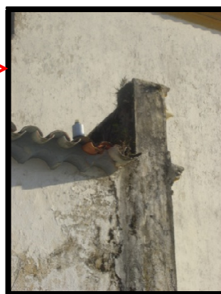
Ilustração 71. Detalhe da ausência de telha (N.S. da Lapa) Fonte: Autora (2007)
