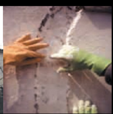
Figura 10. Fissuras (aplicação de mastique) Fonte: Pires Giovanetti (2003)
