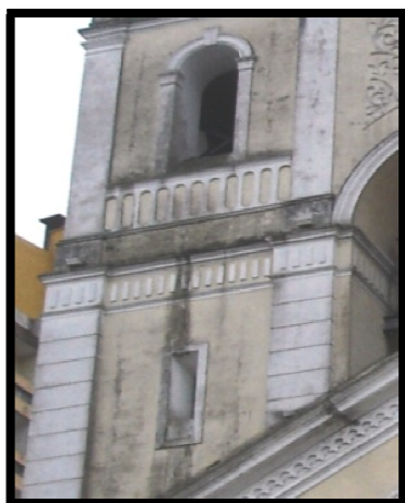
Ilustração 43. Sujidade arrastada pela chuva Fonte: Foto da autora (2006)
