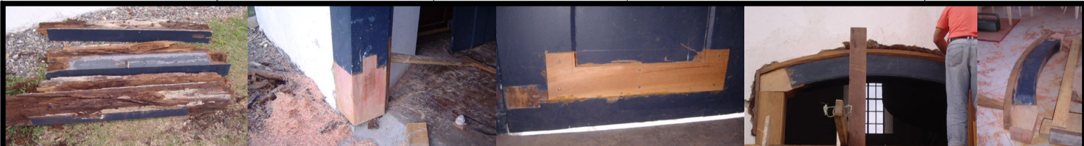
Figura A. Estado das peças das esquadrias Fonte: DEINFRA (2006)
