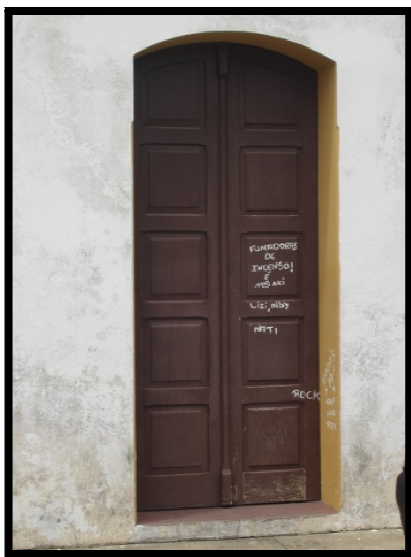
Ilustração 77. Pichação na porta lateral de madeira (Fachada lateral norte)
