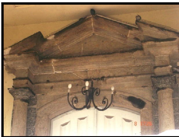
Ilustração 42. Degradação na portada de cantaria da Fachada Frontal.
