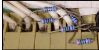
Figura C.5 – Resistores tipo shunt instalados na saída dos transmissores de temperatura.
