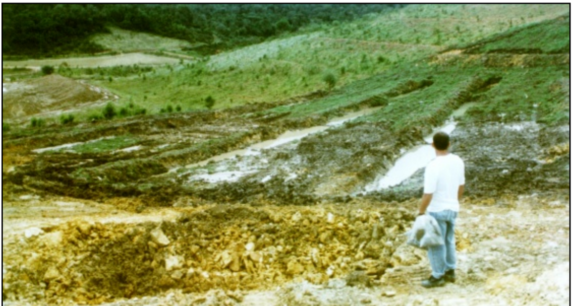
Foto 3 – Drenagem para disciplinar o escoamento das águas das chuvas em área de mineração de Campo Formoso, no município de Doutor Pedrinho, SC – 1995
