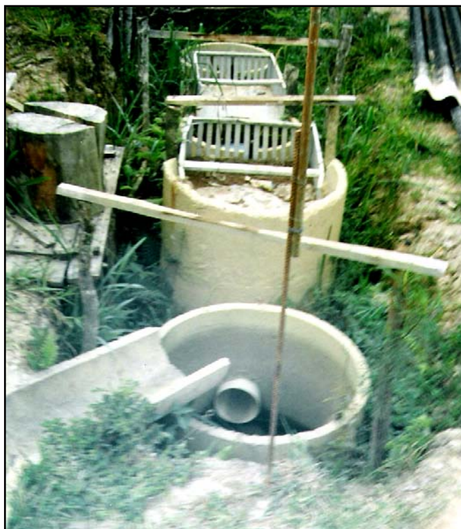
Foto 20 – Detalhe dos coletores e dos divisores Geib – 2006
