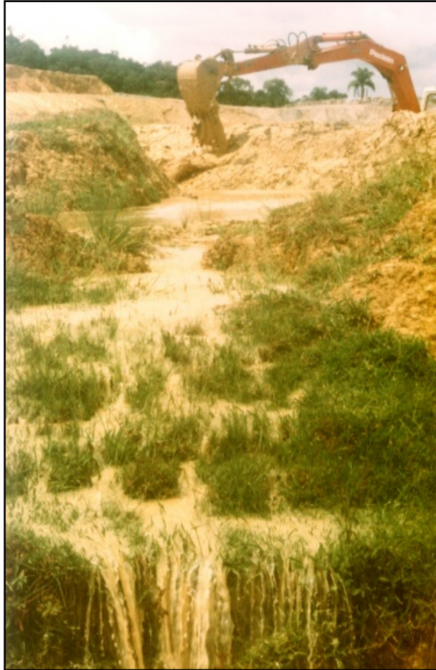
Foto 6 – Lagoas de decantação colmatadas necessitando de manutenção periódica para retirada de sedimentos depositados em área de mineração de Campo Formoso, no município de Doutor Pedrinho, SC – 1995
