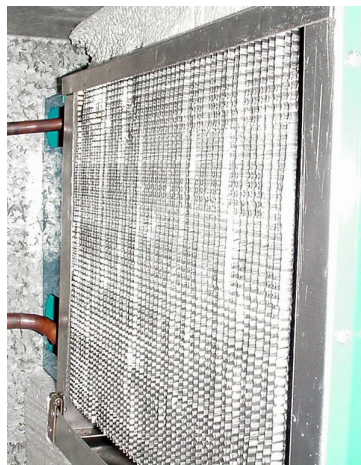
Figura 3.7 – Evaporador da unidade de resfriamento
