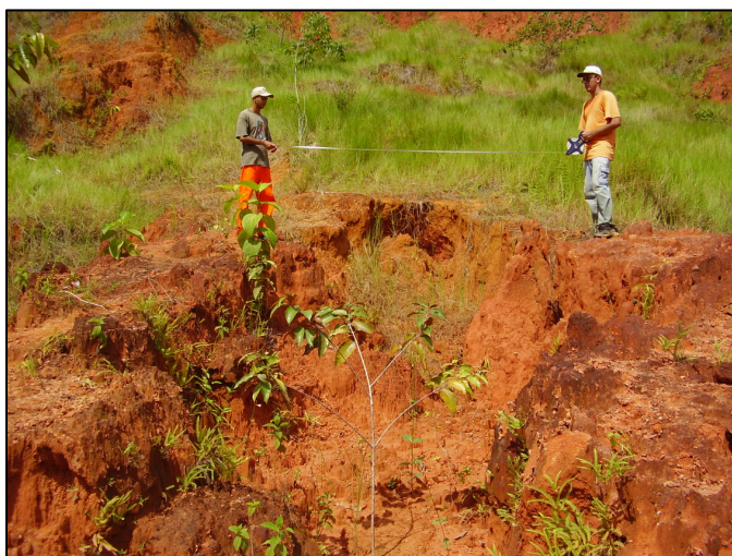
FIGURA 15 – Parâmetros dimensionais das voçorocas Fonte: Antonio F.G. Vieira – julho/2006
