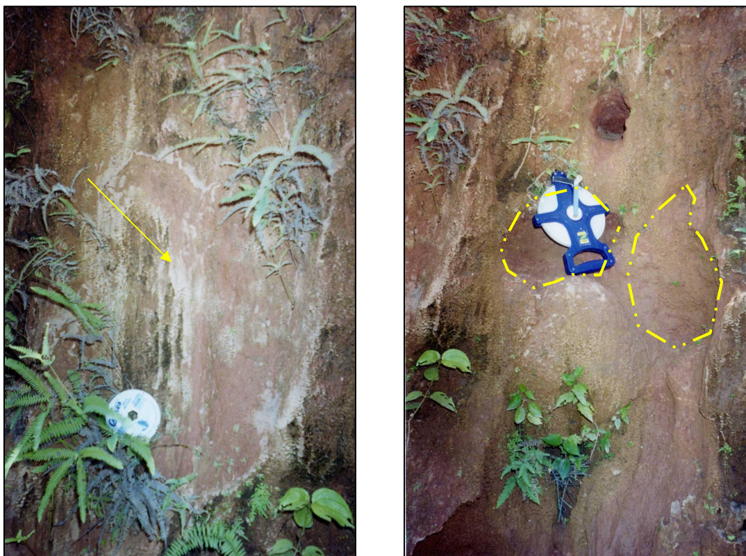
FIGURA 42 e 43 – Escamamentos (esq.) e Marmitas (dir.): ambas no interior da Canelura
