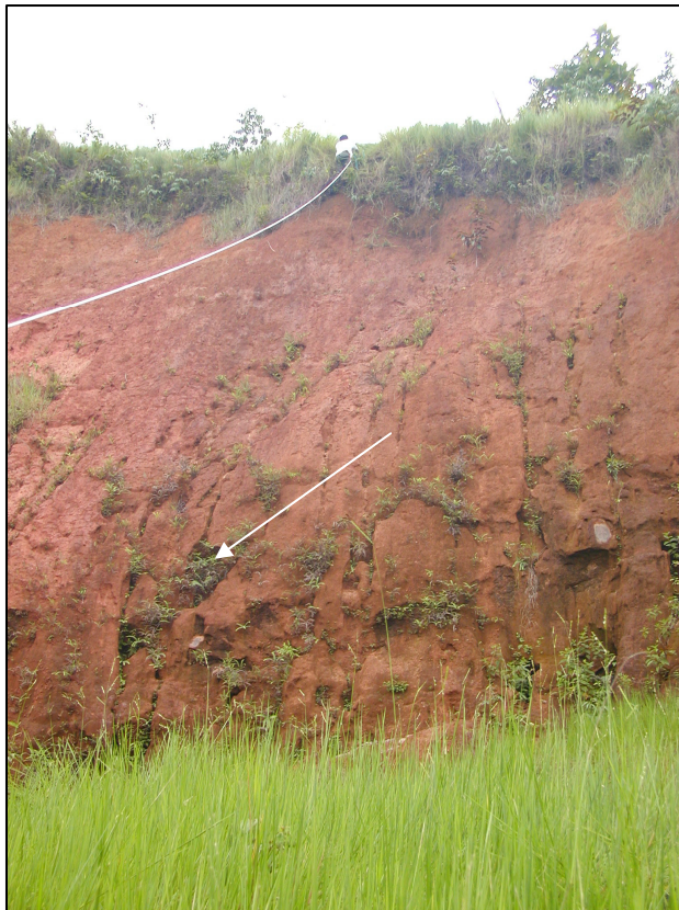
FIGURA 40 – Retrabalhamento erosivo na base da parede do escorregamento em cunha
